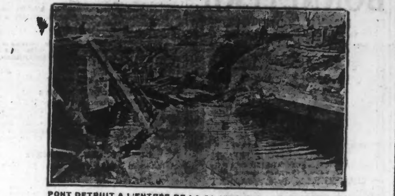
PONT DETRUIT A L'ENTREE DE LA BASSEE SUR L'EMPLACEMENT DUQUEL UN NOUVEAU PONT A ETE CONSTRUIT
