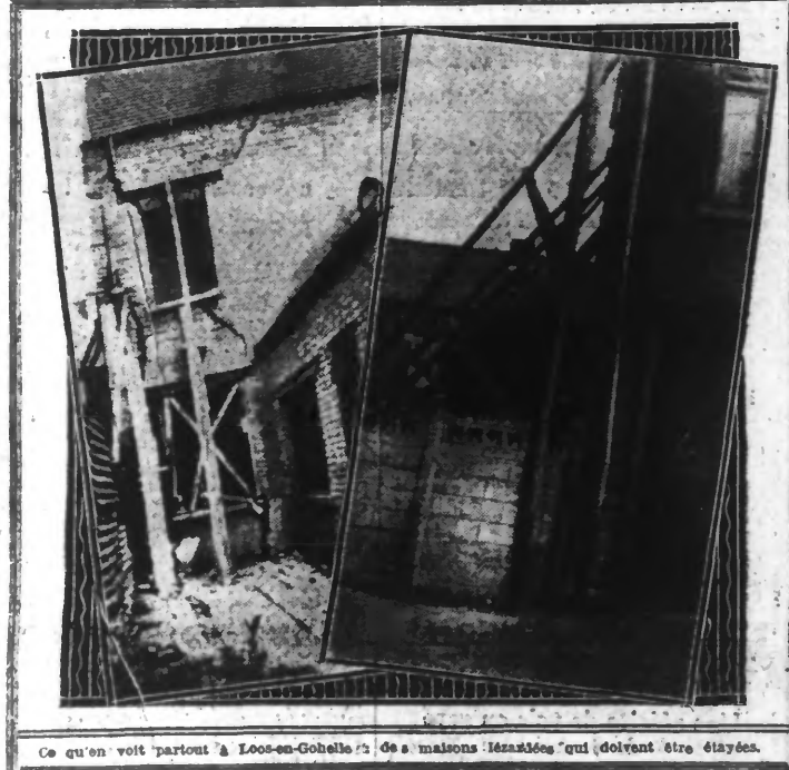
Ce qu'on voit partout à Loos-en-Gohelle : des maisons lézardées qui doivent être démolies.
