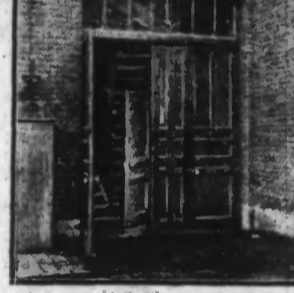
EN HAUT : Le mur de la façade de la propriété VANDERHAEGHEN...
