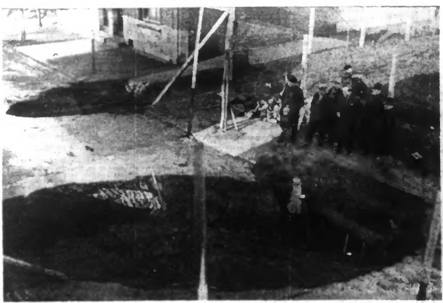
Nous avons signalé, hier, qu'une sape de guerre s'était effondrée rue Montesquieu à MÉRICOURT-SOUS-LENS. Hier les services de la Préfecture du Pas-de-Calais et des Ponts et Chaussées sont descendus sur les lieux pour prendre les précautions utiles en vue d'éviter tout accident. NOTRE PHOTO MONTRÉ LES DEUX EXCAVATIONS COUVRANT UNE SUPERFICIE DE 100 MÈTRES CARRÉS.
