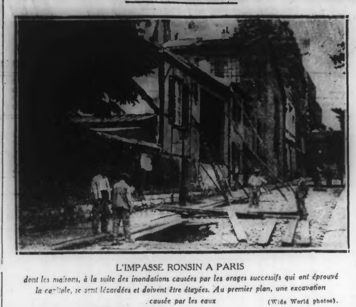
L'IMPASSE RONSIN A PARIS. Sous le vent des inondations causées par les orages successifs qui ont épuisé la capitale, se sont lézardés et doivent être élargis. Au premier plan, une excavation causée par les eaux. (Wide World photos.)
