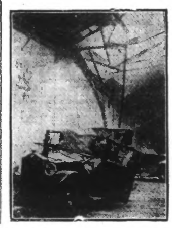
UNE VUE DU GARAGE DU BOULEVARD MONTESQUIEU, A ROUBAIX ENDOMMAGÉ PAR LA CHUTE D'UN MUR
