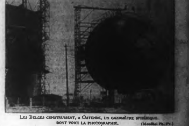
LES BELGES CONSTRUENT, A OSTENDE, UN GAZOMETRE MODERNE. DONT VOICI LA PHOTOGRAPHIE. (Médical Ph. Fr.)
