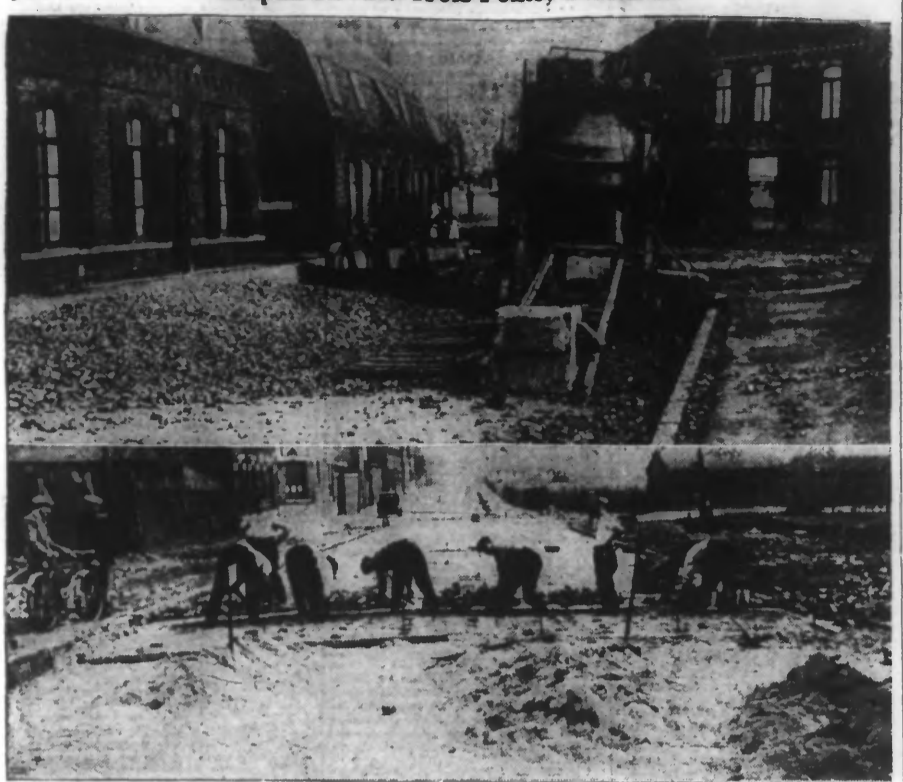
En haut : LES TRAVAUX DE RÉFÉCTION DE LA CHAUSSÉE, RUE D'ANZIN. En bas : LE DÉGAGEMENT DU CARREFOUR DES RUES BRAME ET D'ANZIN, A PROXIMITÉ DE LA GARE DE ROUBAIX-WATRELOS (marchandises).
